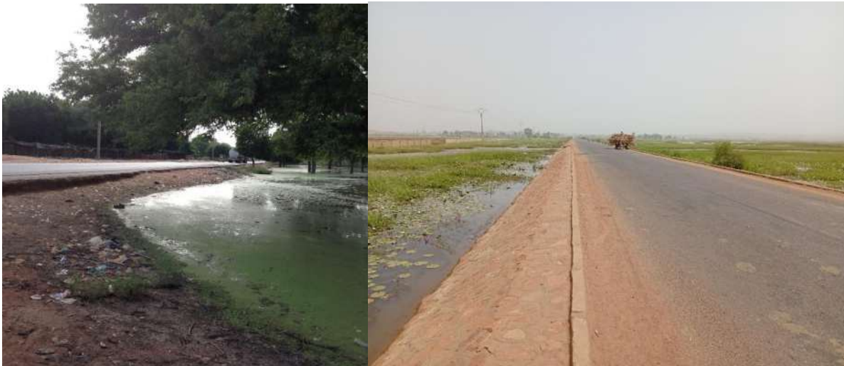
Figures 15 et 16 : Vue des vallées inondables traversées par la route
